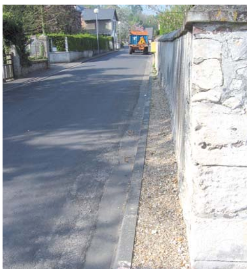
Trottoir quasi inexistant Source : Cete Normandie Centre
