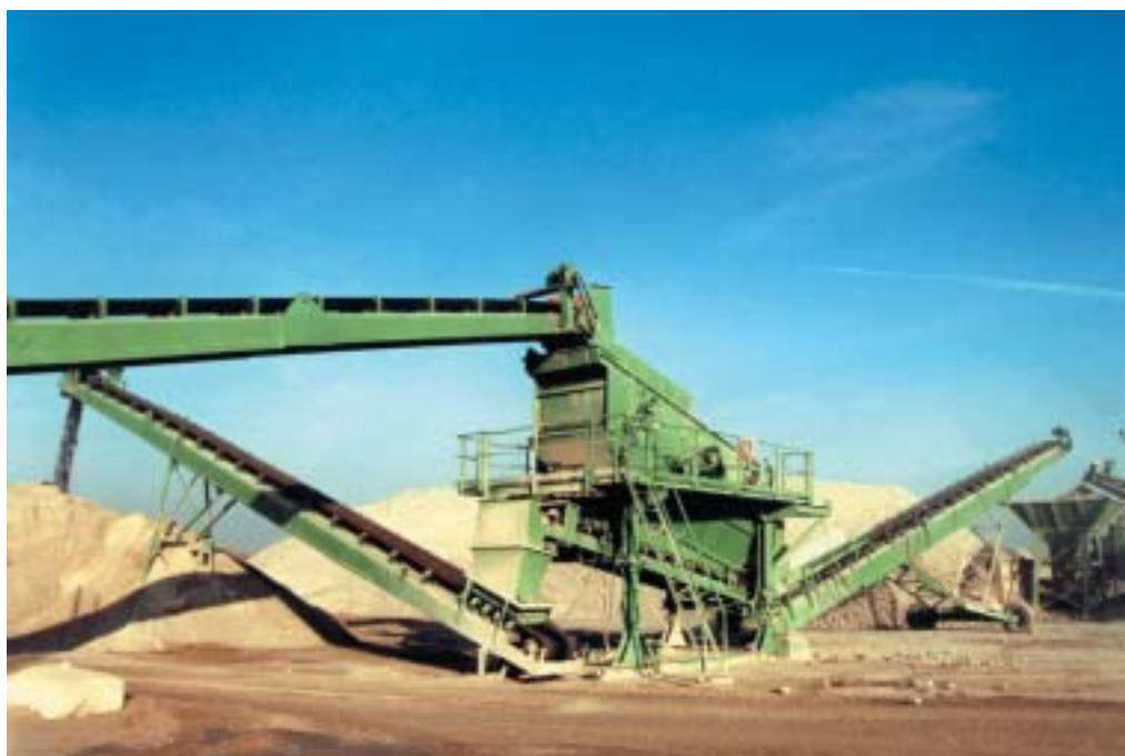
Vue générale d'une installation
