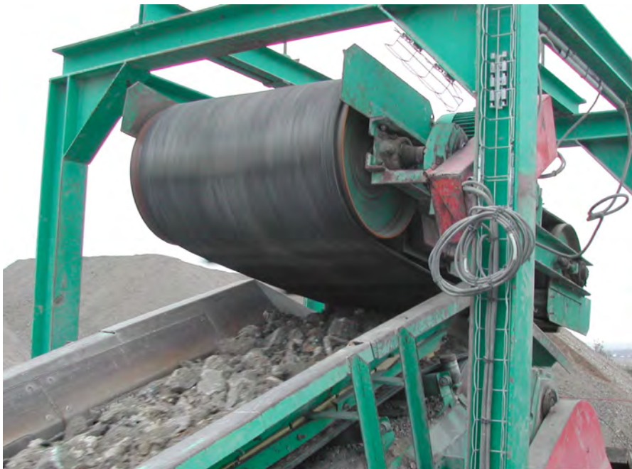
Photo : séparateur magnétique (Source : Eurovia)
