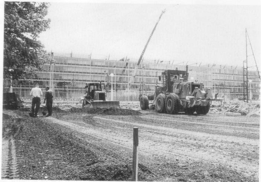
Utilisation de MIOM en marché routier public : parkings de l'École Nationale des Ponts et Chaussées à Marne-la-Vallée
