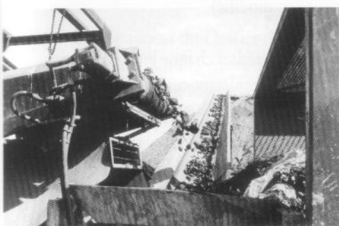
Séparation des éléments les plus légers par tri aéroulique sous la jetée du tapis
