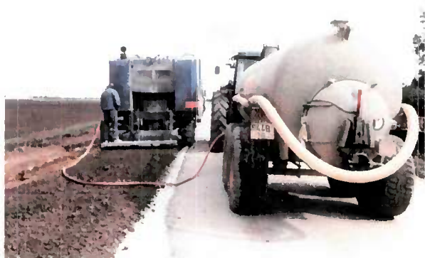
Citerne d'alimentation en eau de l'ARC 700 (APPIA) - RD 833.
