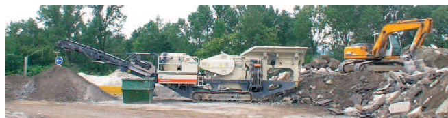
Exemple d'installation mobile
