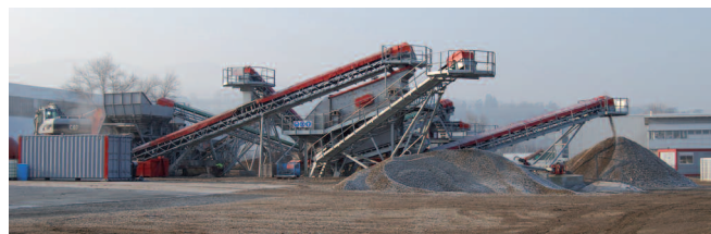
Exemple d'installation fixe
