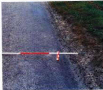
Affaissement de plus de 5 cm nécessitant un reprofilage
