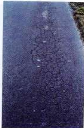
Faïençage nécessitant un scellement et une imperméabilisation
