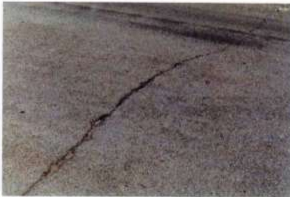
Fissure nécessitant un pontage
