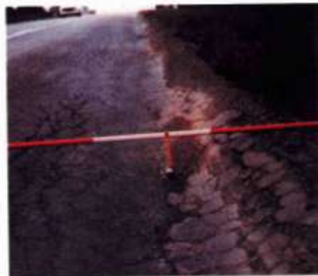
Affaissement nécessitant une purge
