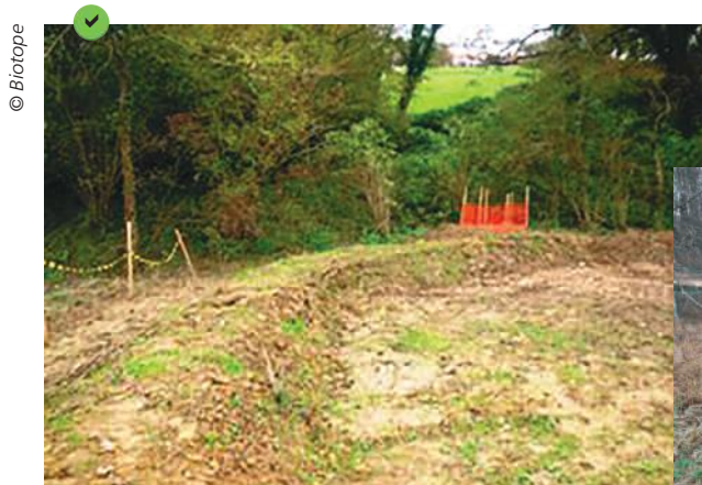
Merlon en bas de pente, équipé d'une surverse (identifiée en orange). Il protège une berge défrichée et dirige l'eau vers un milieu végétalisé
