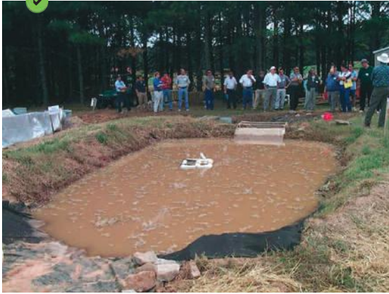
Piège à sédiments avec berges végétalisées.
