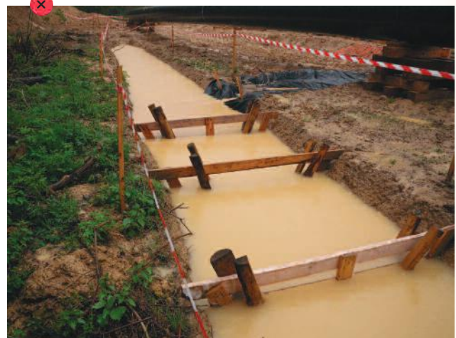
Fossé de décantation inefficace : sur sols très argileux, les particules les plus « fines » ne décantent pas.
