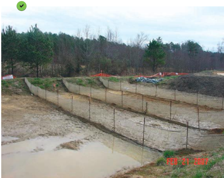
Bassin de décantation équipé de barrières perméables. Une fois le bassin vidangé, les sédiments sont prêts à être curés.
