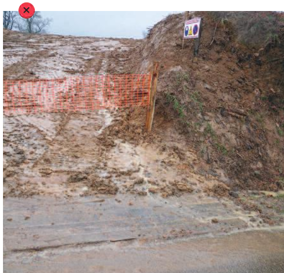
Accès au chantier non aménagé.
