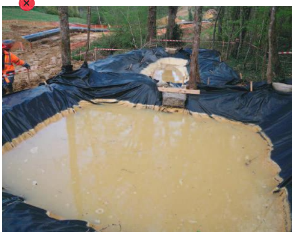
Bassin de décantation inefficace : forme inadaptée ne diminuant pas suffisamment la vitesse du courant et les turbulences hydrauliques.
