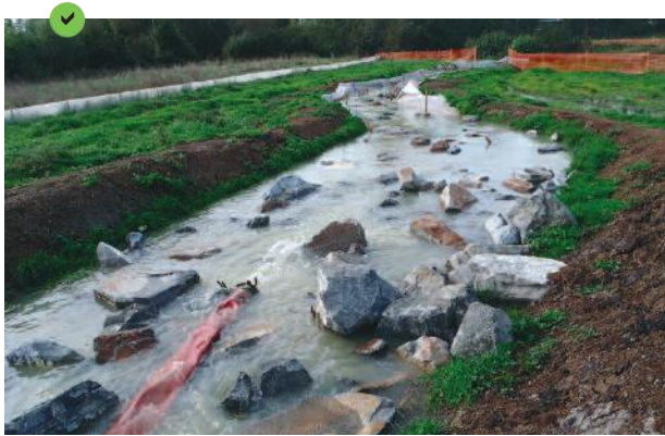
Rejet temporaire au sein d'une dérivation provisoire équipée de blocs dissipant l'énergie hydraulique.
