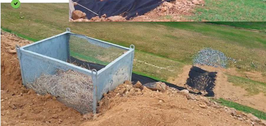
Descente d'eau provisoire sur remblai de grande hauteur, avec passage au travers d'une cage de filtration (en amont) et d'un dispositif anti-érosion (en aval).
