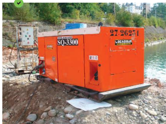
Mise en place d'un géotextile absorbant au point d'alimentation en essence des groupes électrogènes.
