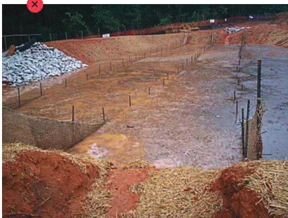
L'eau ne doit pas passer par-dessus les barrières.
