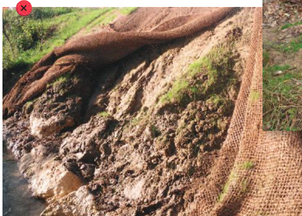
Infiltrations d'eau sous le filet et déstabilisation de l'ensemble du dispositif.
