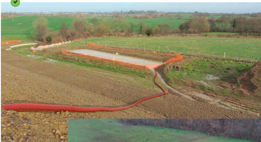
Drain de pente.
