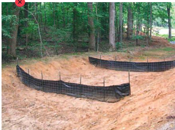
Les barrières perméables en géotextile ne sont pas tendues jusqu'aux talus du bassin de décantation.
