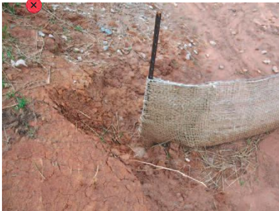
La mauvaise disposition des barrières entraîne des contournements et des processus d'érosion des talus.
