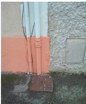
Boîte de branchement - Source : ATTF
