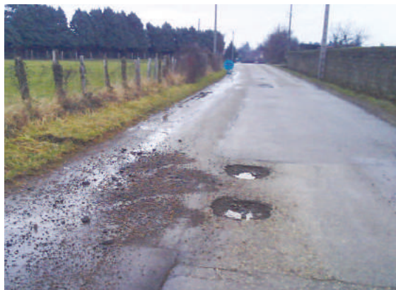
Dégradation de la voie
