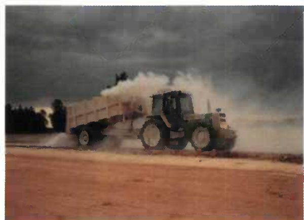
Le comportement des matériels et des techniques d'exécution fait partie des actions d'assurance de la qualité ....
