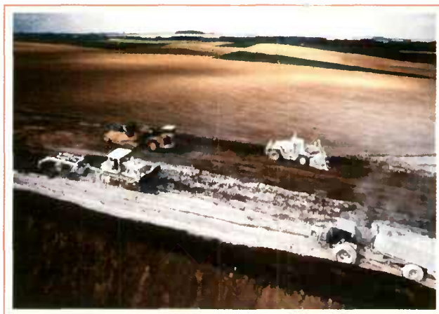
La diversité des opérations élémentaires nécessitées par la réalisation des couches de forme en sol traité génère des dispersions d'exécution dont il faut tenir compte dans le dimensionnement.
