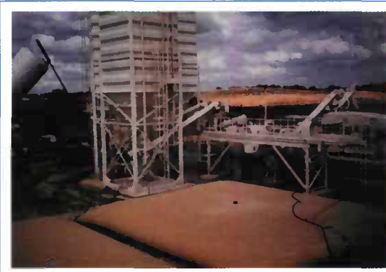
Vue d'ensemble d'une centrale de fabrication d'un limon traité à 1,5 % de chaux vive + 6 % de liant hydraulique. À remarquer, au premier plan, la grosse citerne souple de plus de 200 m 3 utilisée pour le stockage de l'eau destinée à l'ajustement de l'état hydrique du mélange.
