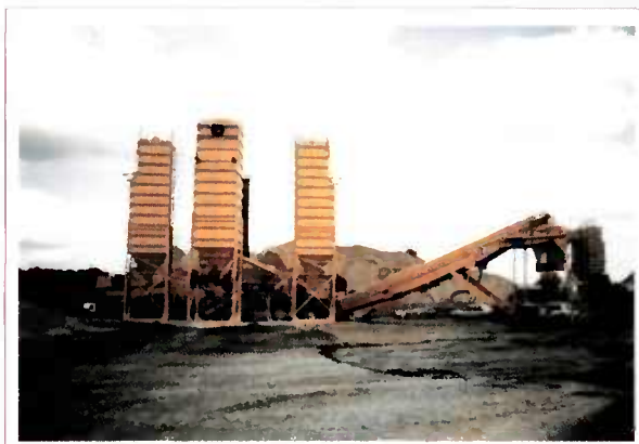
Silos fixes de 100 t utilisés dans une centrale de fabrication de sable traité au ciment avec correction granulométrique.
