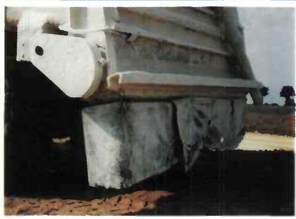
... ainsi que la vérification de leur état de fonctionnement. Ici le délabrement des jupes anti-poussières laisse mal augurer des autres aspects et notamment de la précision du doseur !
