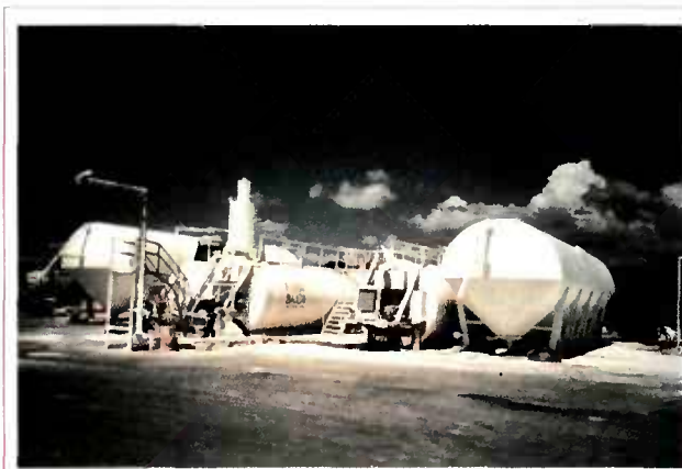
Centrale de fabrication de lait de chaux (par extinction de chaux vive).
