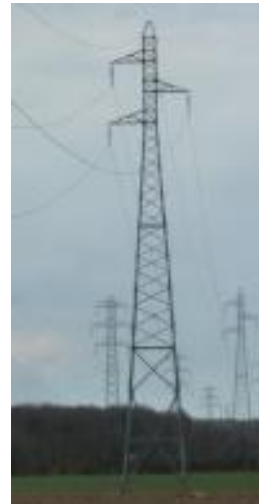
Réseau aérien HTB de 90 kV
