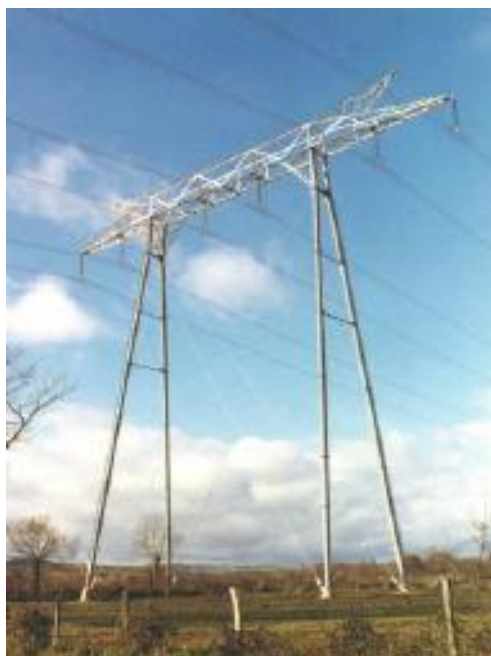
Réseau aérien HTB de 225 kV
