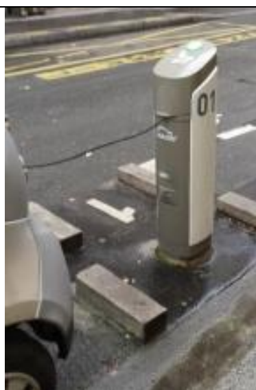
Borne de recharge électrique
