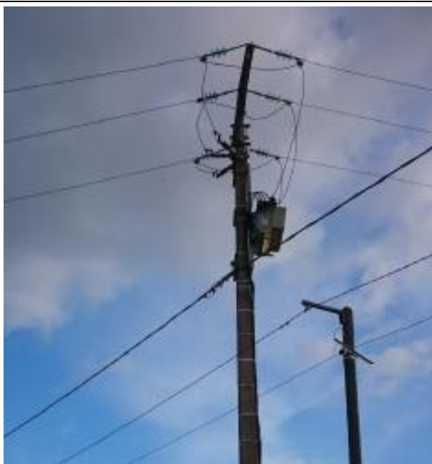
Réseau aérien BT torsadé sur support HTA
