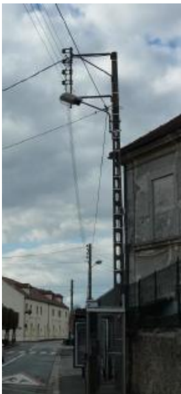
Éclairage public BT sur support béton commun
