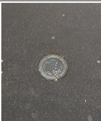
Éclairage par le sol
