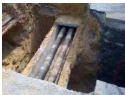
Réseau en caniveau
