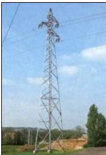
Réseau aérien HTB de 63 kV sur pylône
