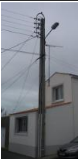
Réseau aérien BT sur support commun
