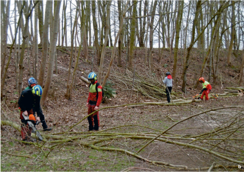
Figures 17.4a et 17.4b. Exemple de métré des volumes de bois à extraire et vue d'un chantier de dépressage
