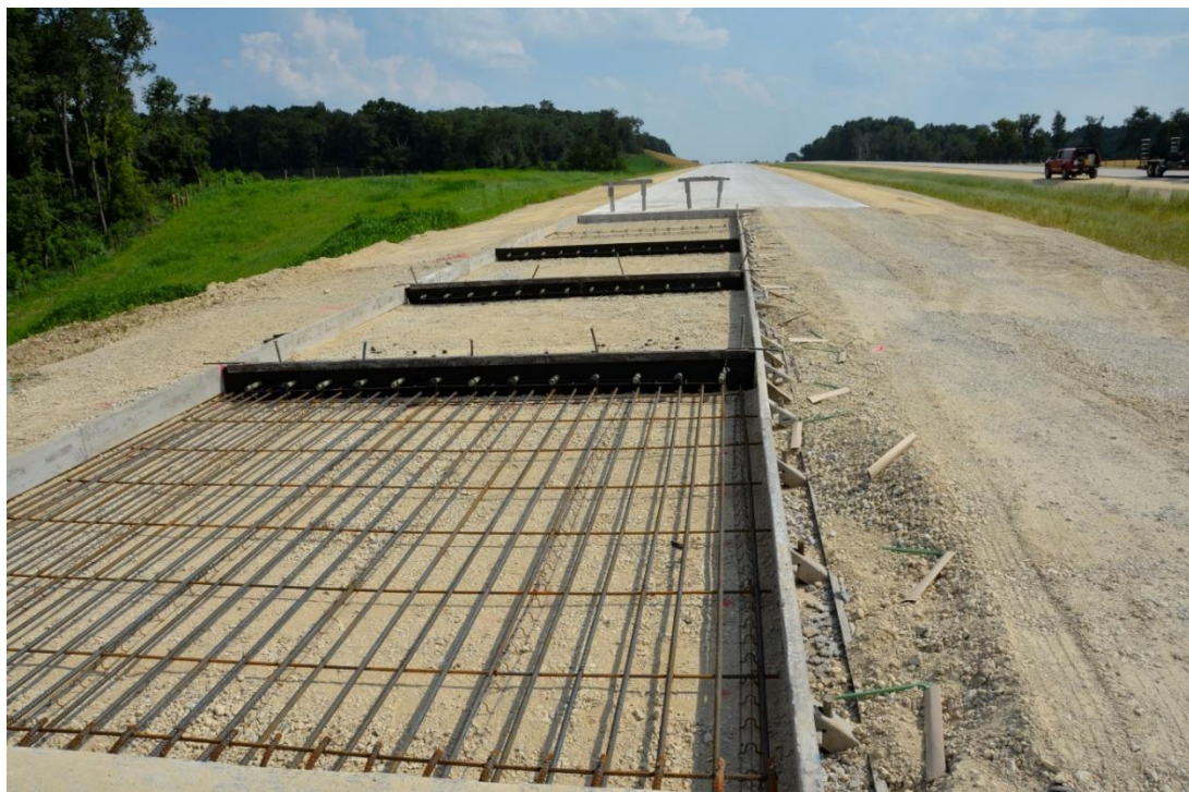
Figure 7.2.4-1 : une série de joints de dilatation à l'extrémité d'une chaussée en béton jointoyée, Wisconsin, USA (photo : Luc Rens)
