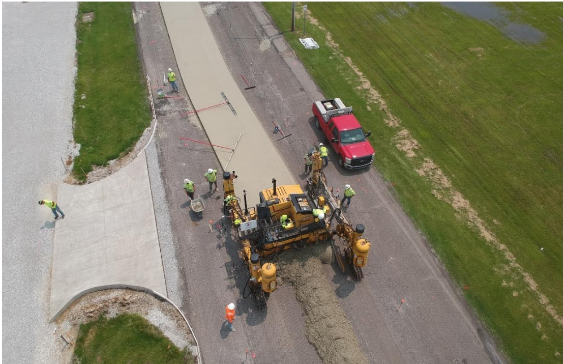
Figure 7.2.2-1 : Revêtement en béton fibré d'une route locale revêtue d'asphalte Grant County, Indiana, États-Unis, 2020 (photo : ACPA)
