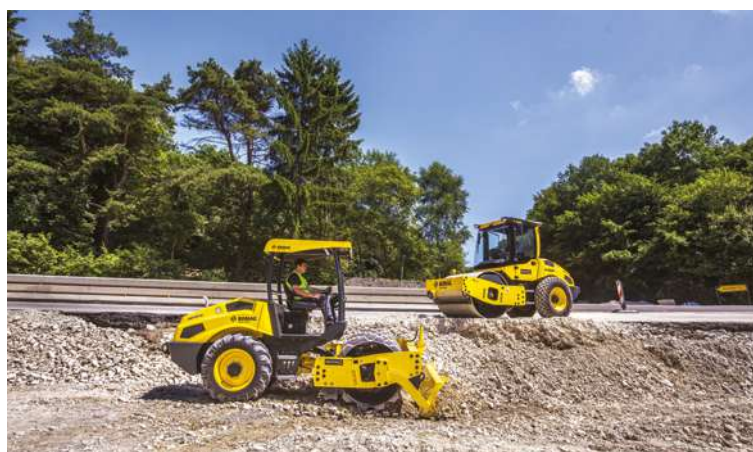
Photographie 25: Compacteur vibrant à pieds dameurs en premier plan, compacteur vibrant à cylindre lisse au second plan (Source: BOMAG)
