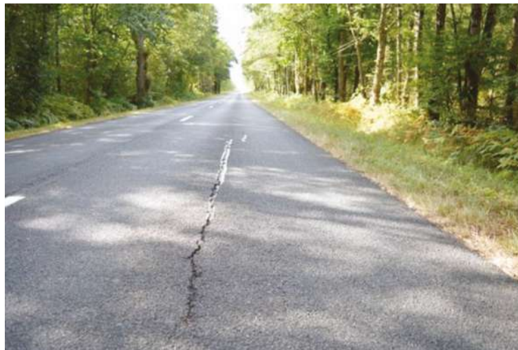
Photographie 1: Exemple de phénomène de retrait avec apparition d'une fissure longitudinale (Source : Observatoire des Routes Sinistrées par la Sécheresse pour optimiser les réparations (ORSS))
