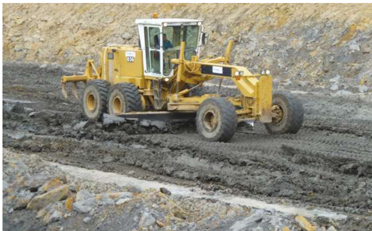
Photographie 20: Cas typique d'une PST0 impropre à la circulation de chantier et à la mise en œuvre d'une couche de forme (Source : SCSNE)
